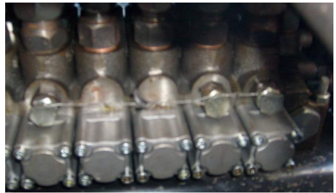
Рис.3 Пломбирование гидрораспределителя (снаружи кабины, вид снизу со стороны экскаваторного оборудования).
