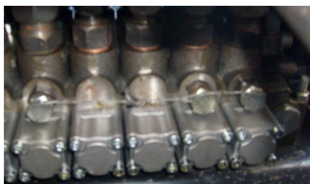
Рис.8 Пломбирование гидрораспределителя (снаружи кабины, вид снизу со стороны экскаваторного оборудования).
